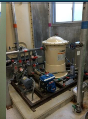
プールの水の浄化設備
